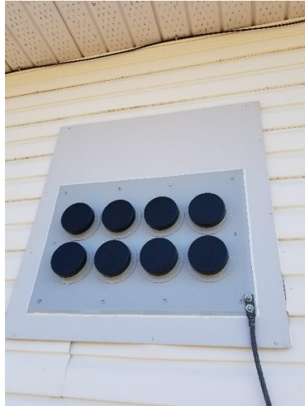
Figure 6: Nouvelle entrée de câbles
