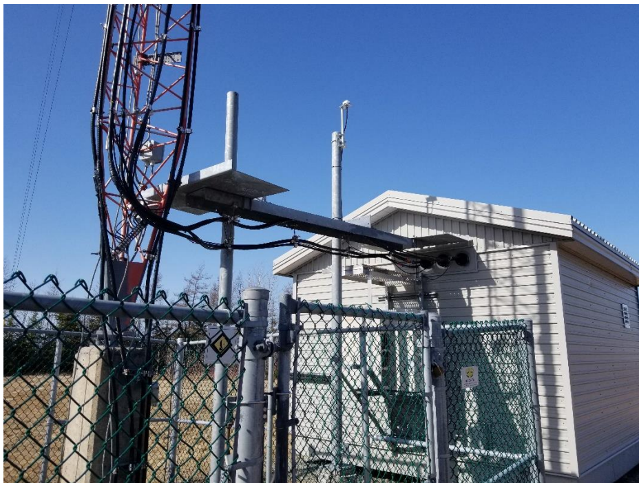
Figure 1: Base du pylône et bâtiment Telus
