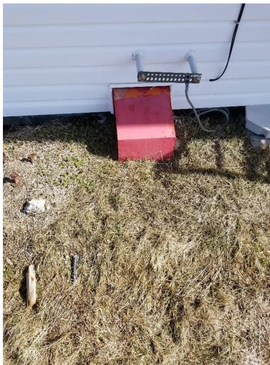
Figure 5: Entrée des câbles souterrains existants
